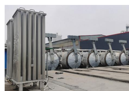
河南理工大学碳化生产线
